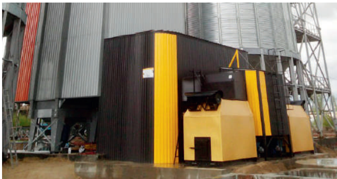
KMZ Industries теплогенератор, 14 МВт. Полтавська обл.
