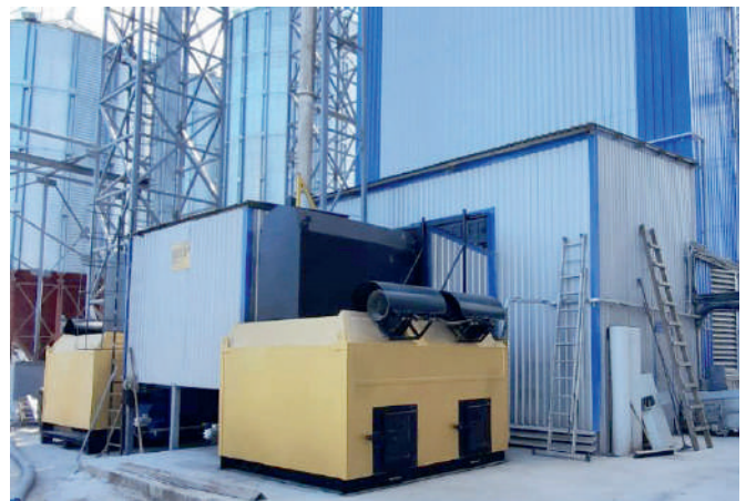
Buhler теплогенератор, 20 МВт. Чернігівська обл.
