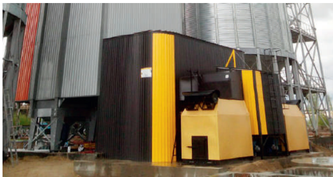
KMZ Industries теплогенератор, 14 МВт. Полтавська обл.
