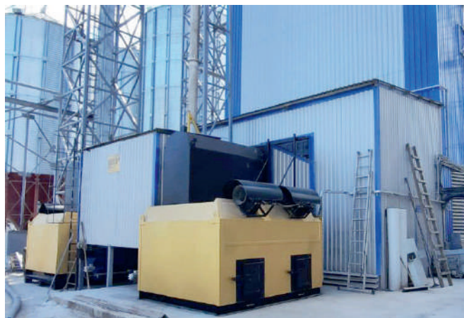
Buhler теплогенератор, 20 МВт. Чернігівська обл.
