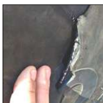
приклад бічного пошкодження
