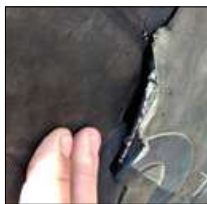
приклад бічного пошкодження
